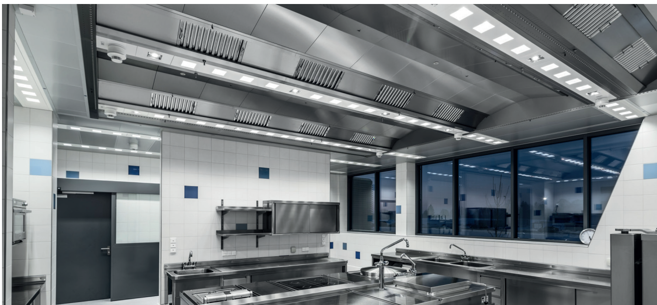
Santo Service (Holzkirchen, Deutschland)
